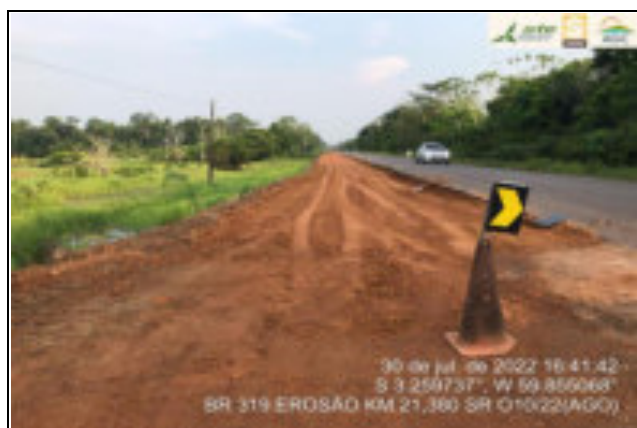
BR-319/AM EROSÃO LE KM: 21,380 ESTACA: 419
