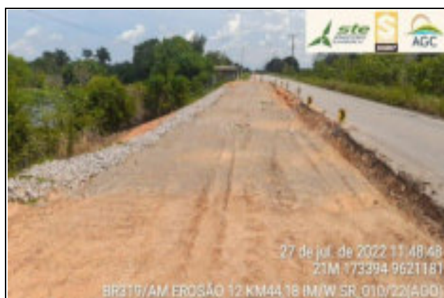
BR-319/AM EROSÃO LE KM: 44,180 ESTACA: 1.559
