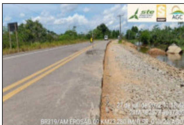
BR-319/AM EROSÃO LD KM: 23,280 ESTACA: 514
