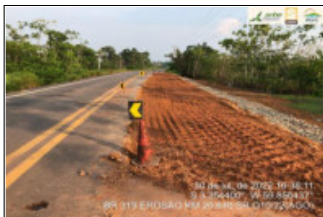
BR-319/AM EROSÃO LD KM: 20,640 ESTACA: 382
