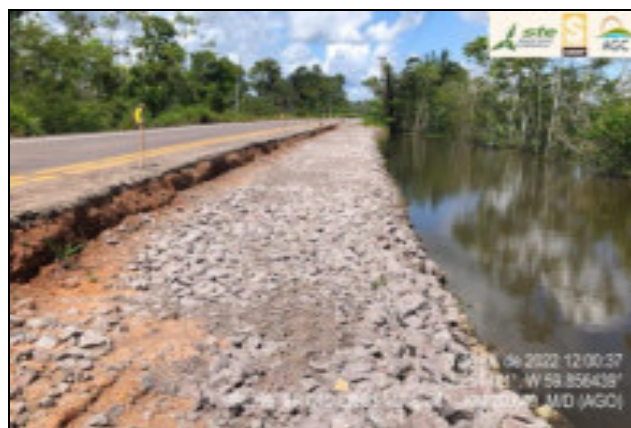
BR-319/AM EROSÃO LD KM: 20,640 ESTACA: 382
