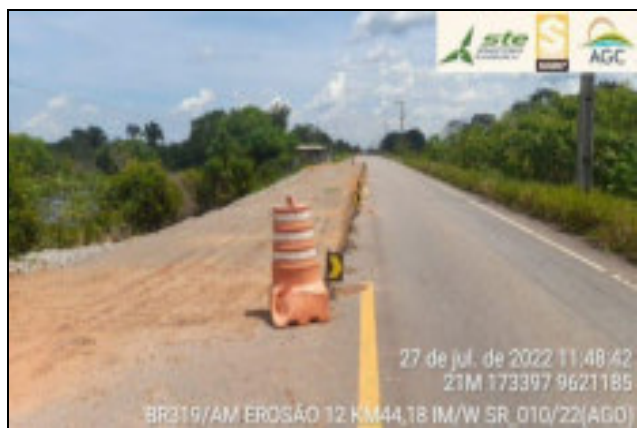
BR-319/AM EROSÃO LE KM: 44,180 ESTACA: 1.559
