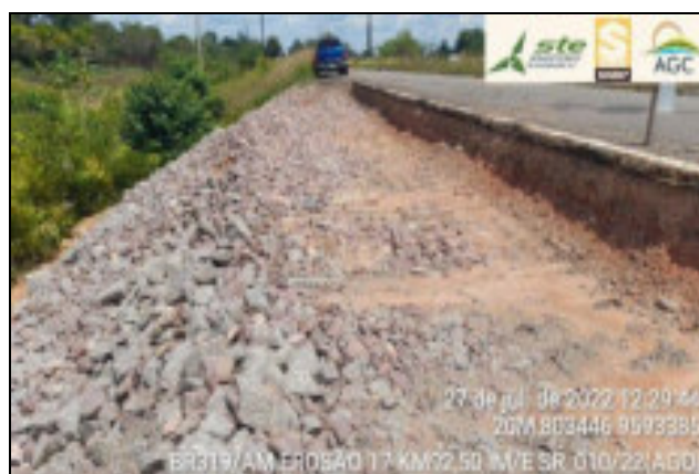
BR-319/AM EROSÃO LE KM: 92,500 ESTACA: 3.975
