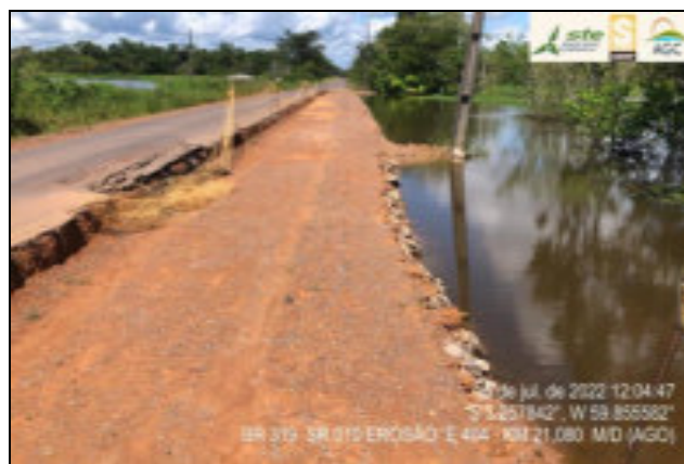
5 de jul. de 2022 12:04:47 S 3.257842°, W 59.855582° BR 319 SR 010 EROÇÃO E 404 - KM 21,080 MID (AGO)
