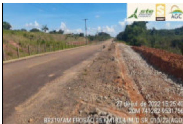
BR-319/AM EROSÃO LD KM: 183,40 ESTACA: 8.519
