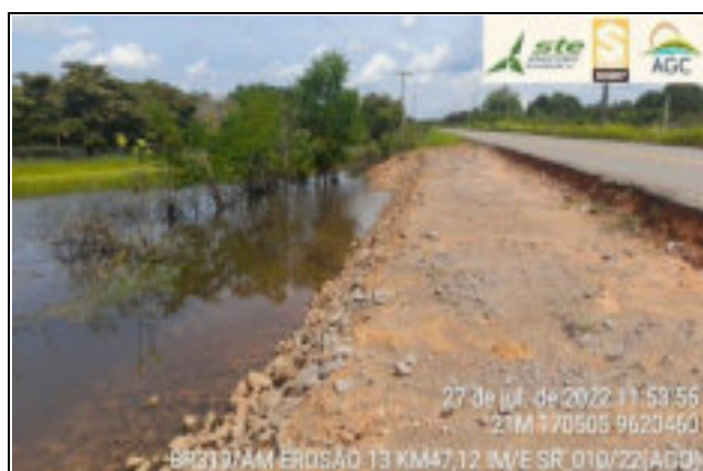
BR-319/AM EROSÃO LE KM: 47,120 ESTACA: 1.705
