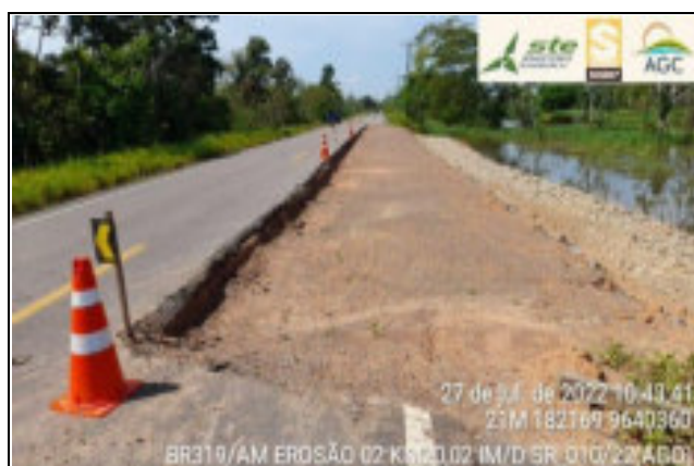
BR-319/AM EROSÃO LD KM: 20,020 ESTACA: 350
