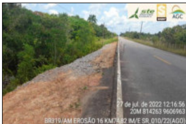
BR-319/AM EROSÃO LE KM: 74,820 ESTACA: 3.091
