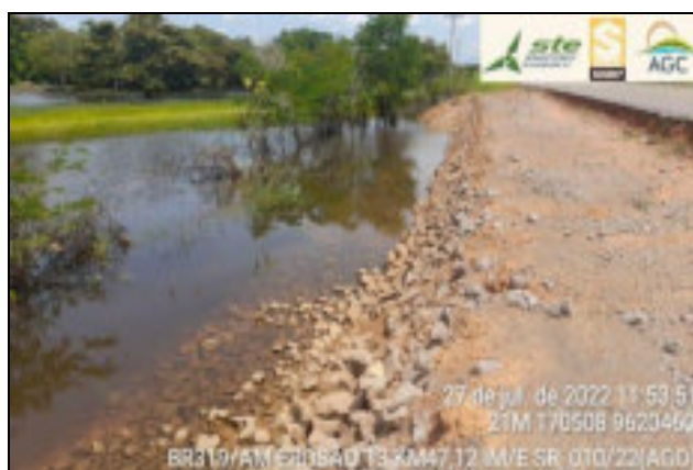
BR-319/AM EROSÃO LE KM: 47,120 ESTACA: 1.705
