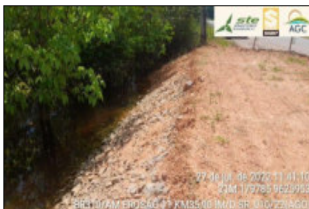
BR-319/AM EROSÃO LD KM: 35,900 ESTACA: 1.145
