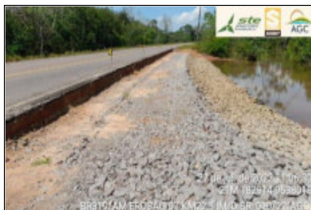
BR-319/AM EROSÃO LD KM: 22,500 ESTACA: 475
