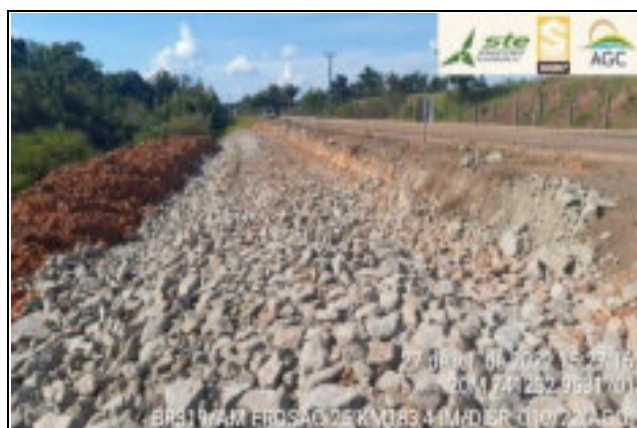
BR-319/AM EROSÃO LD KM: 183,400 ESTACA: 8.519
