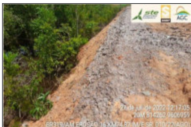
BR-319/AM EROSÃO LE KM: 74,820 ESTACA: 3.091
