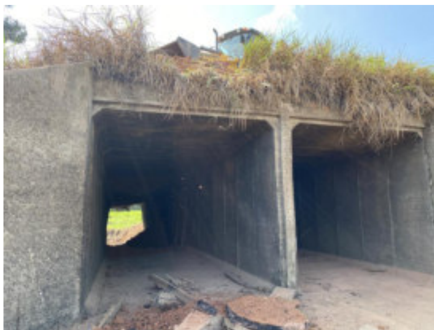
FOTO 5: MONTANTE DO BDCC 3,00M. SITUAÇÃO CRÍTICA DAS ADUELAS LADO ESQUERDO.
