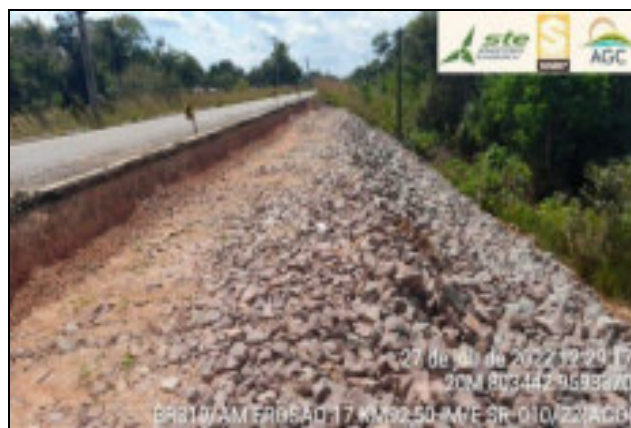
BR-319/AM EROSÃO LE KM: 92,500 ESTACA: 3.975
