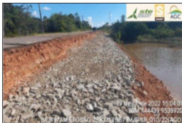
BR-319/AM EROSÃO LD KM: 175,640 ESTACA: 8.132
