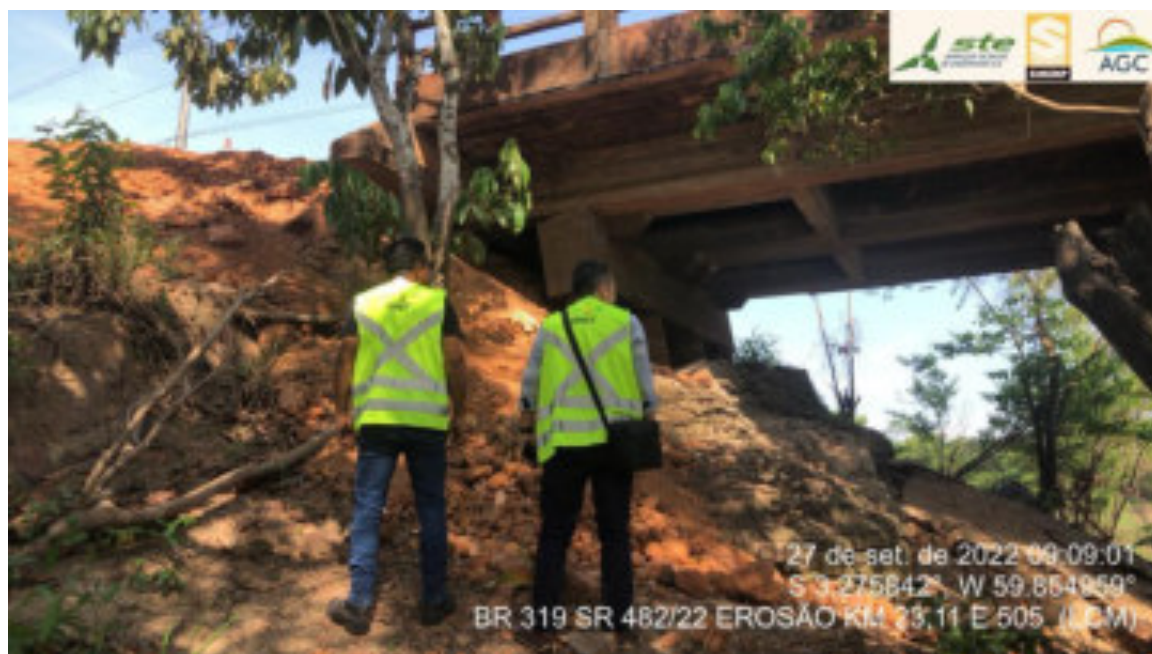
FOTO 12: SITUAÇÃO CRÍTICA DA VIGA DE ENCONTRO DA PONTE
