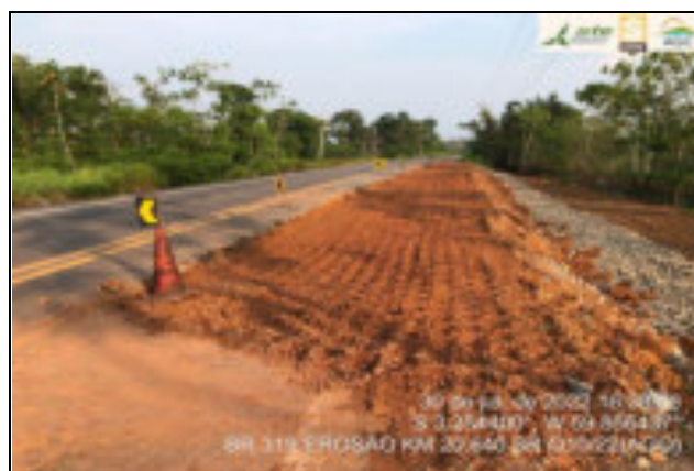
BR-319/AM EROSÃO LD KM: 20,640 ESTACA: 382
