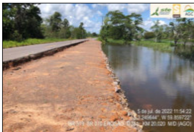
BR-319/AM EROSÃO LD KM: 20,020 ESTACA: 350
