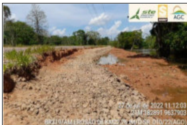
27 de jul. de 2022 11:12:03 21M282891 9637903 BR 319/AM EROSÃO DA KM 22,76 MID SR 010/22(AGO) BR-319/AM EROSÃO LD KM: 22,700 ESTACA: 485
