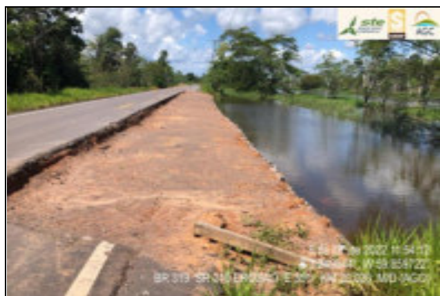
BR-319/AM EROSÃO LD KM: 20,020 ESTACA: 350
