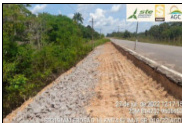
BR-319/AM EROSÃO LE KM: 74,820 ESTACA: 3.091
