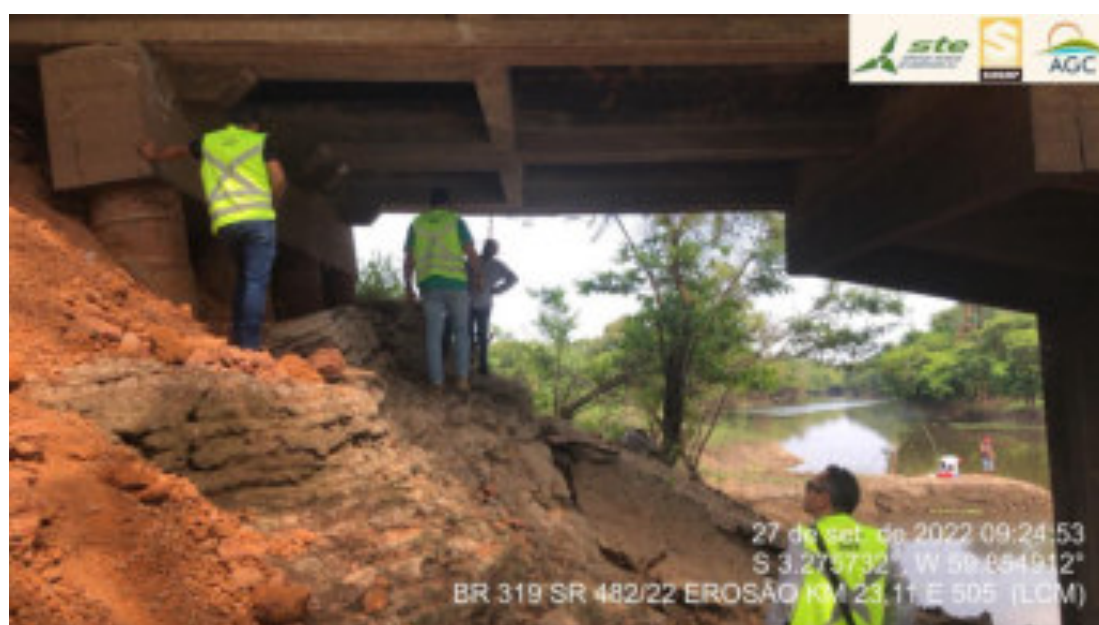
FOTO 13: SITUAÇÃO CRÍTICA DA VIGA DE ENCONTRO DA PONTE E “RIP RAP” EM DESLIZAMENTO
