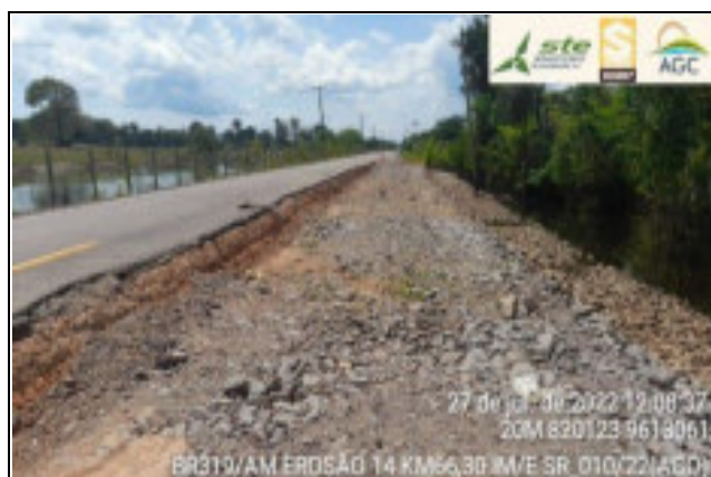
BR-319/AM EROSÃO LE KM: 66,300 ESTACA: 2.665
