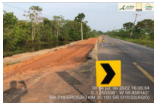
BR-319/AM EROSÃO LE KM: 20,100 ESTACA: 355
