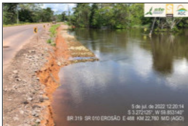
5 de jul. de 2022 12:20:14 S 3.272125°, W 59.853148° BR 319 SR 010 EROSÃO E 488 KM 22,760 MID (AGO) BR-319/AM EROSÃO LD KM: 22,700 ESTACA: 485
