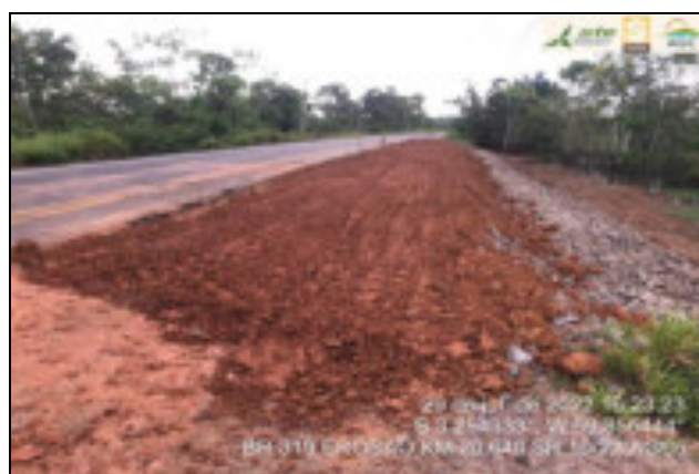
BR-319/AM EROSÃO LD KM: 20,640 ESTACA: 382
