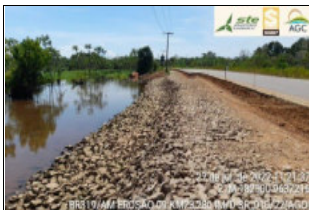
BR-319/AM EROSÃO LD KM: 23,280 ESTACA: 514
