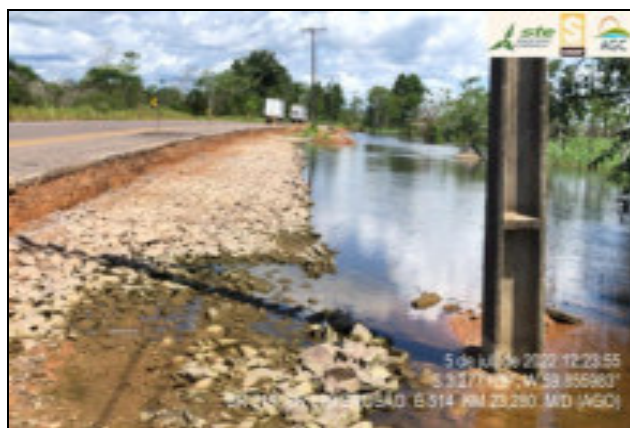
BR-319/AM EROSÃO LD KM: 23,280 ESTACA: 514
