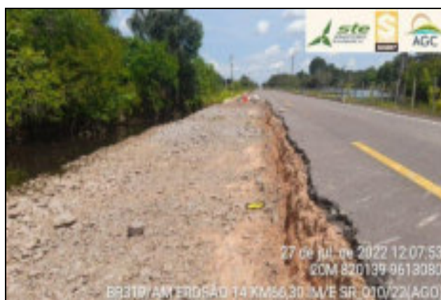
BR-319/AM EROSÃO LE KM: 66,300 ESTACA: 2.665
