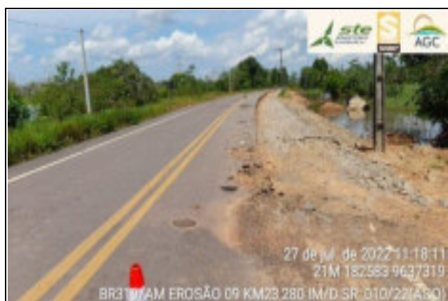
BR-319/AM EROSÃO LD KM: 23,280 ESTACA: 514
