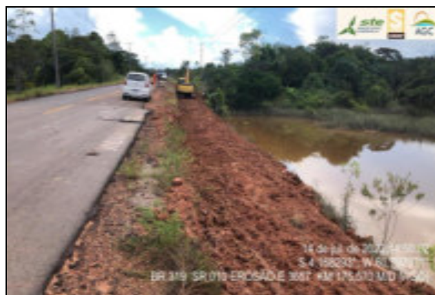
BR-319/AM EROSÃO LD KM: 175,640 ESTACA: 8.132
