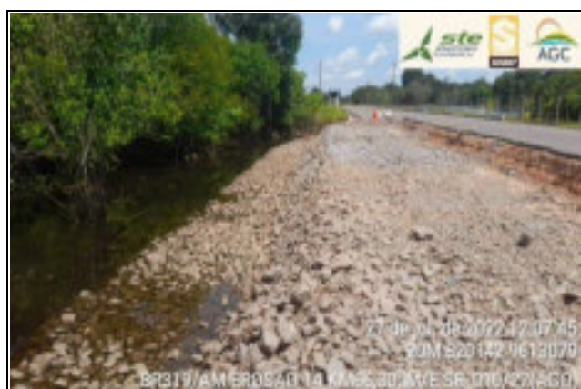
BR-319/AM EROSÃO LE KM: 66,300 ESTACA: 2.665
