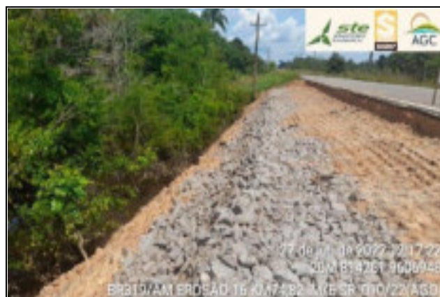
BR-319/AM EROSÃO LE KM: 74,820 ESTACA: 3.091
