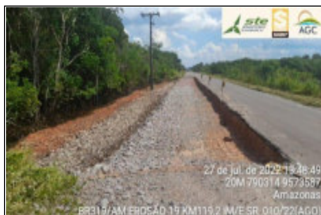
BR-319/AM EROSÃO LE KM: 119,920 ESTACA: 5.346
