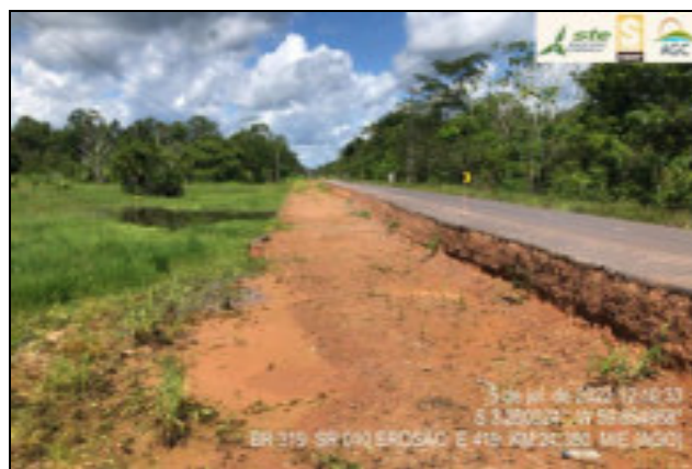
BR-319/AM EROSÃO LE KM: 21,380 ESTACA: 419
