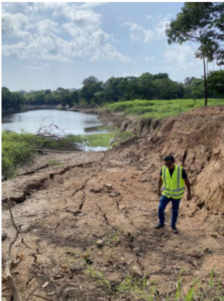
FOTO 10: EROSÕES À JUSANTE DO BDCC
