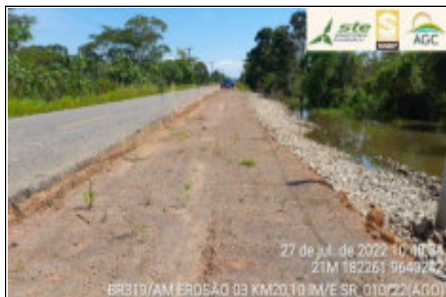
BR-319/AM EROSÃO LE KM: 20,100 ESTACA: 355
