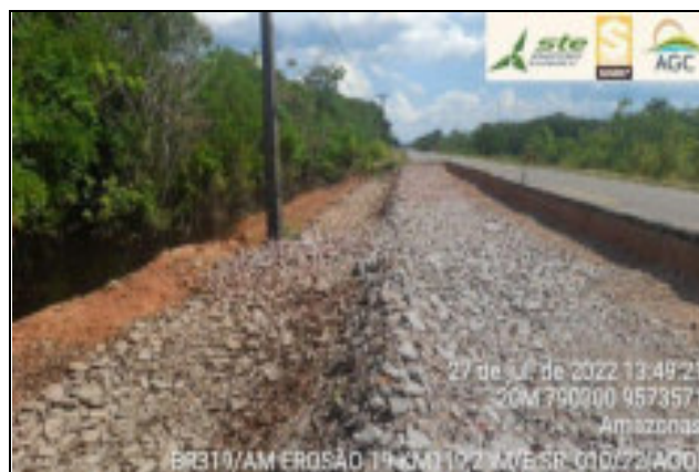
BR-319/AM EROSÃO LE KM: 119,920 ESTACA: 5.346
