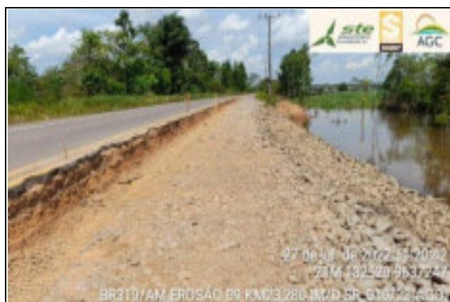
BR-319/AM EROSÃO LD KM: 23,280 ESTACA: 514
