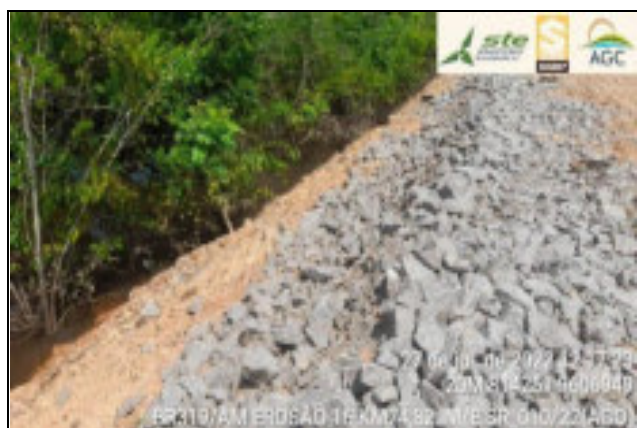
BR-319/AM EROSÃO LE KM: 74,820 ESTACA: 3.091
