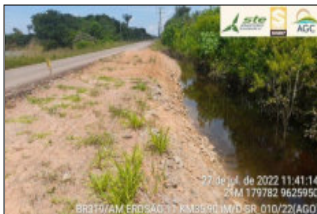
BR-319/AM EROSÃO LD KM: 35,900 ESTACA: 1.145
