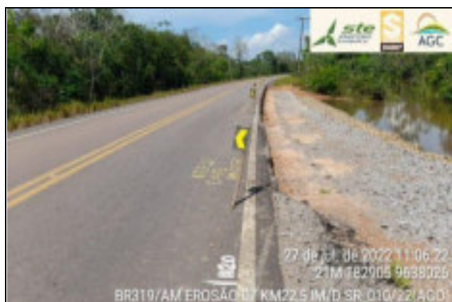
BR-319/AM EROSÃO LD KM: 22,500 ESTACA: 475
