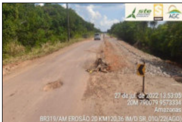
BR-319/AM EROSÃO LD KM: 120,360 ESTACA: 5.368
