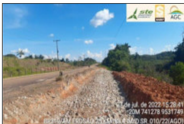
BR-319/AM EROSÃO LD KM: 183,400 ESTACA: 8.519
