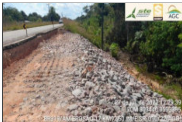
BR-319/AM EROSÃO LE KM: 92,500 ESTACA: 3.975
