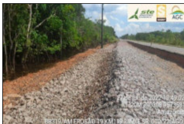
BR-319/AM EROSÃO LE KM: 119,920 ESTACA: 5.346
