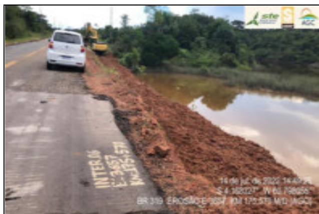
BR-319/AM EROSÃO LD KM: 175,640 ESTACA: 8.132
