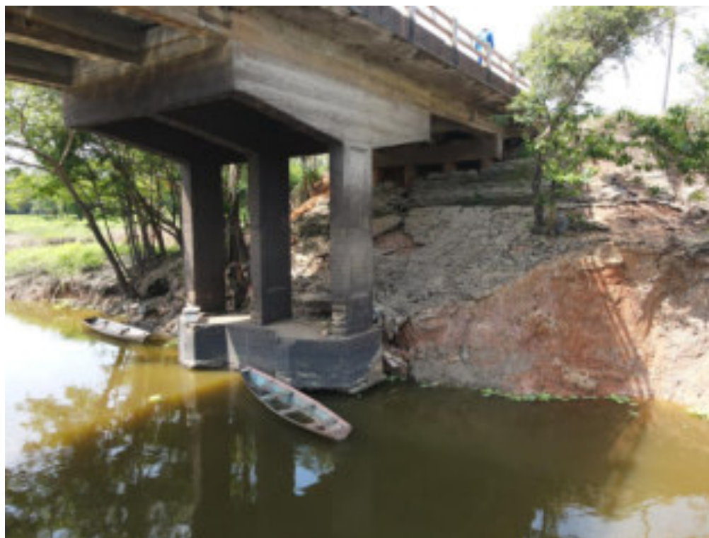
Foto 14: Visão dos pilares no encontro e “rip rap” em estado de erosão
