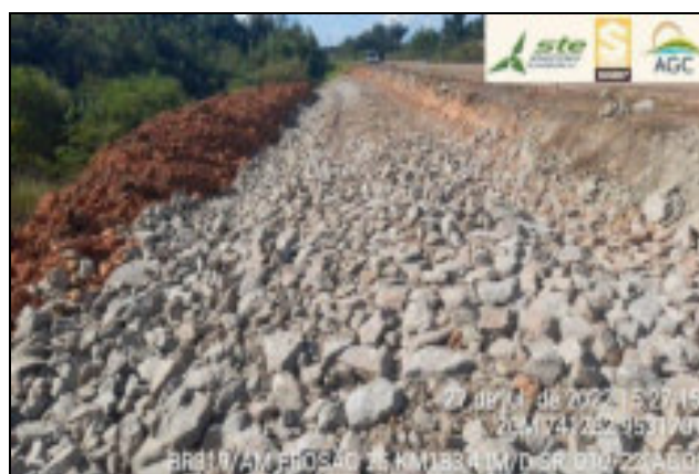
BR-319/AM EROSÃO LD KM: 183,400 ESTACA: 8.519
