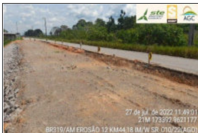
BR-319/AM EROSÃO LE KM: 44,180 ESTACA: 1.559
