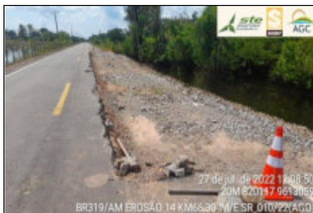
BR-319/AM EROSÃO LE KM: 66,300 ESTACA: 2.665
