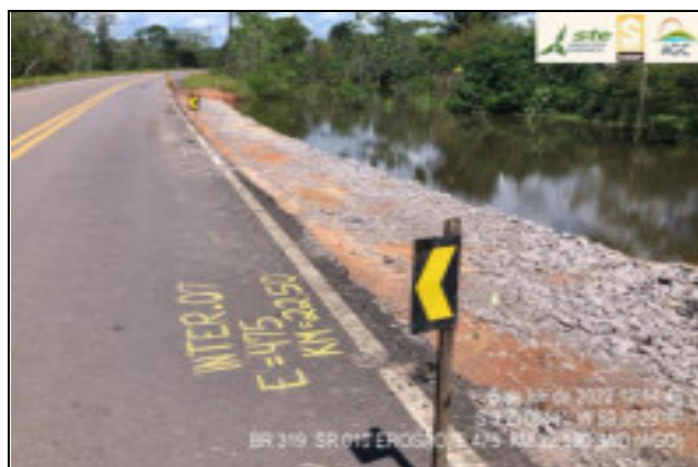
BR-319/AM EROSÃO LD KM: 22,500 ESTACA: 475
