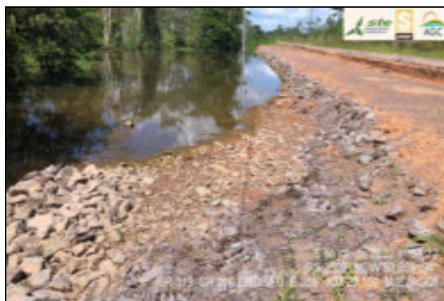
BR-319/AM EROSÃO LE KM: 20,100 ESTACA: 355
