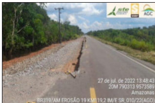
BR-319/AM EROSÃO LE KM: 119,920 ESTACA: 5.346
