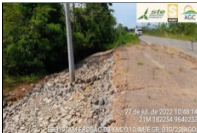
BR-319/AM EROSÃO LE KM: 20,100 ESTACA: 355
