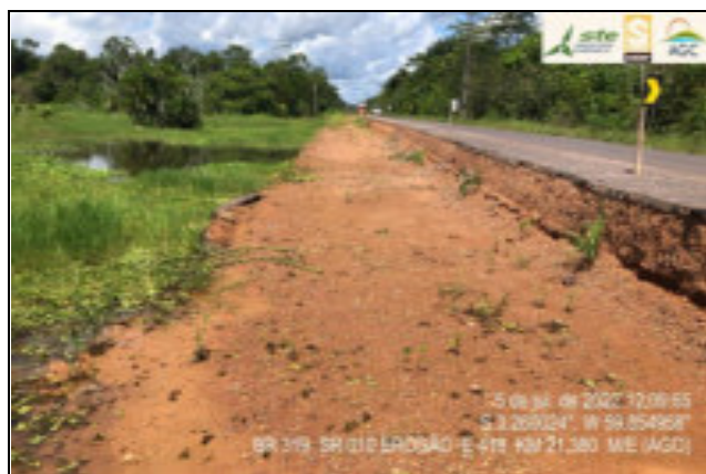
BR-319/AM EROSÃO LE KM: 21,380 ESTACA: 419
