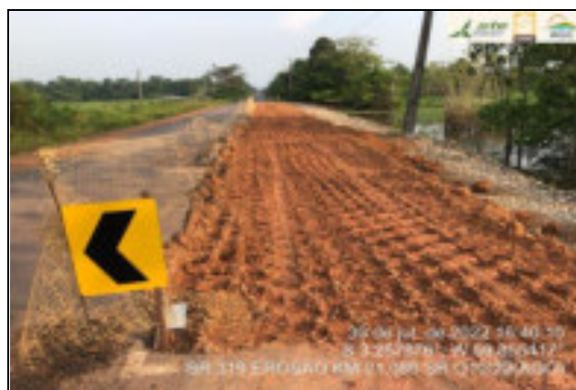
29 de jul. de 2022 16:40:19 S 3.257876°, W 59.856417° BR 319 EROÇÃO KM 21,080 SR 07022(AGO)
