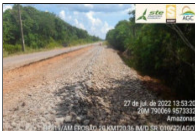
BR-319/AM EROSÃO LD KM: 120,360 ESTACA: 5.368
