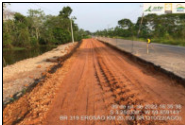
BR-319/AM EROSÃO LE KM: 20,100 ESTACA: 355
