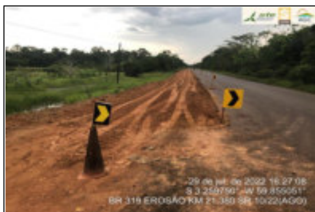
BR-319/AM EROSÃO LE KM: 21,380 ESTACA: 419
