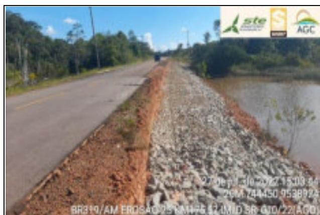
BR-319/AM EROSÃO LD KM: 175,640 ESTACA: 8.132
