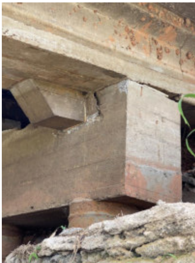
Foto 15: Tombamento da viga de encontro
