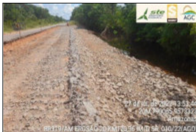
BR-319/AM EROSÃO LD KM: 120,360 ESTACA: 5.368
