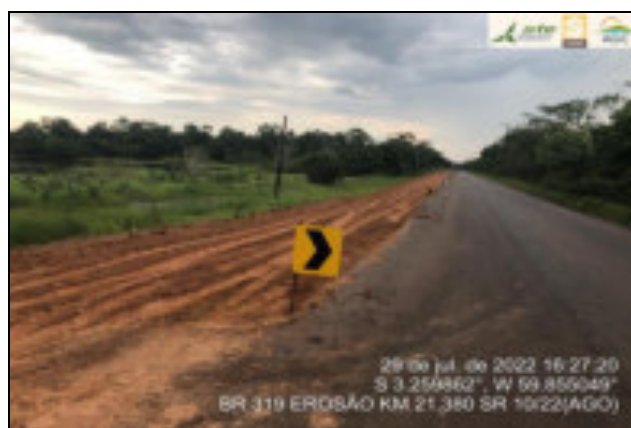
BR-319/AM EROSÃO LE KM: 21,380 ESTACA: 419
