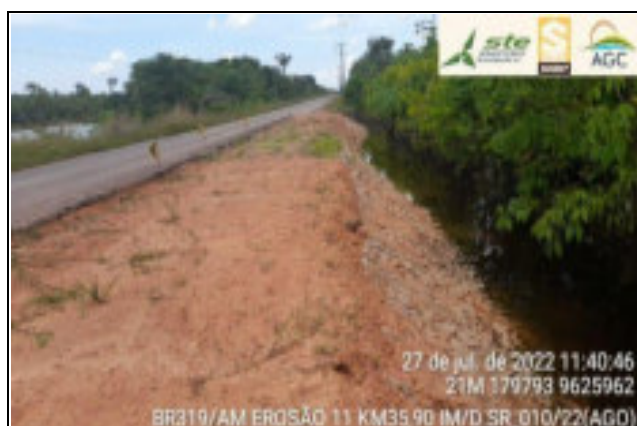
BR-319/AM EROSÃO LD KM: 35,900 ESTACA: 1.145
