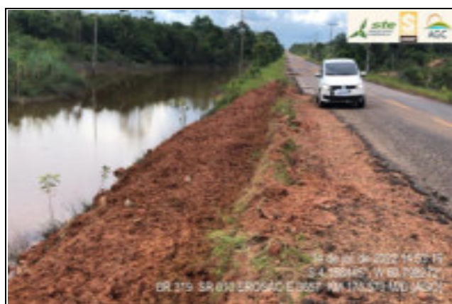
BR-319/AM EROSÃO LD KM: 175,640 ESTACA: 8.132
