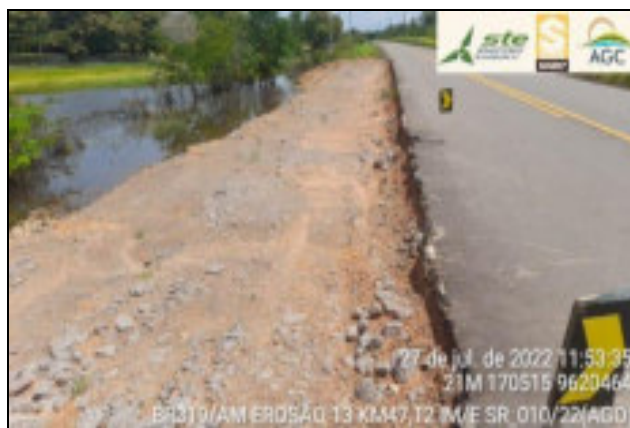
BR-319/AM EROSÃO LE KM: 47,120 ESTACA: 1.705
