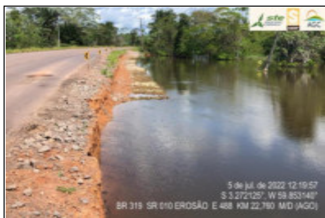
5 de jul. de 2022 12:19:57 S 3.272125°, W 59.853148° BR 319 SR 010 EROSÃO E 488 KM 22,760 MID (AGO) BR-319/AM EROSÃO LD KM: 22,700 ESTACA: 485
