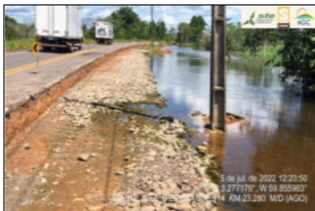
BR-319/AM EROSÃO LD KM: 23,280 ESTACA: 514
