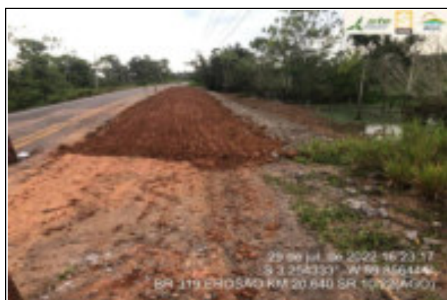
BR-319/AM EROSÃO LD KM: 20,640 ESTACA: 382
