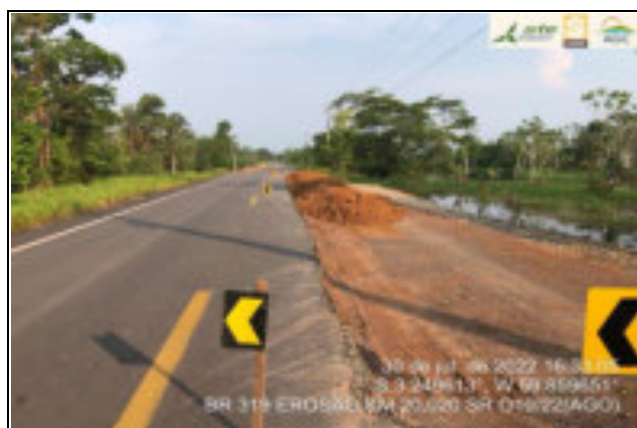
BR-319/AM EROSÃO LD KM: 20,020 ESTACA: 350
