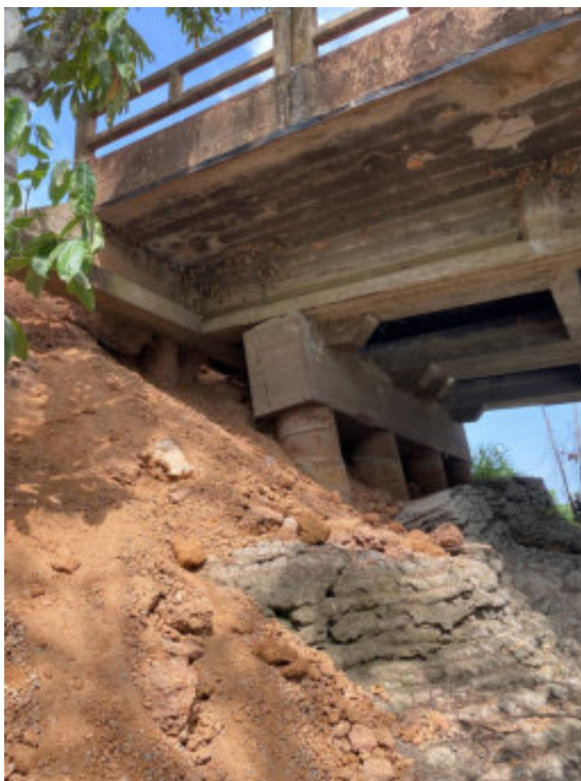
FOTO 11: SITUAÇÃO CRÍTICA DA VIGA DE ENCONTRO DA PONTE
