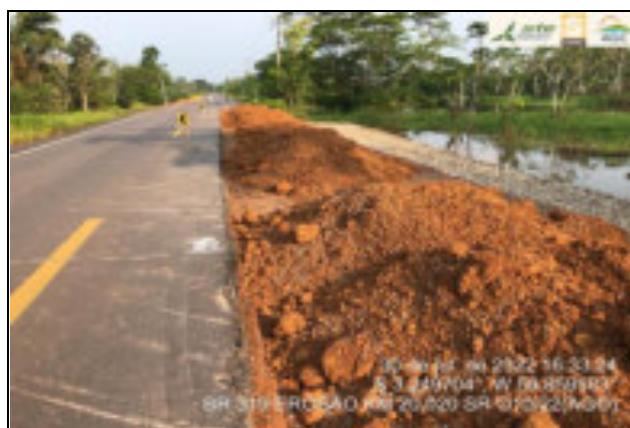
BR-319/AM EROSÃO LD KM: 20,020 ESTACA: 350
