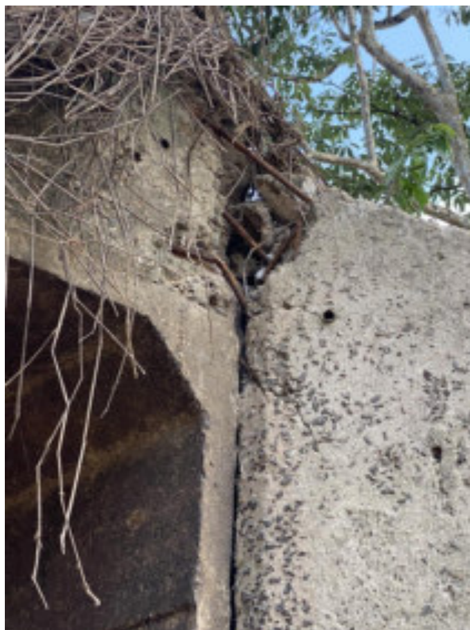
FOTO 9: AÇO DO ENCONTRO DAS ADUELAS E ALAS DO BDCC EM ESTADO DE RUPTURA .
