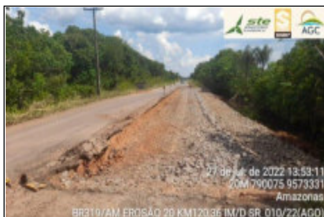
BR-319/AM EROSÃO LD KM: 120,360 ESTACA: 5.368
