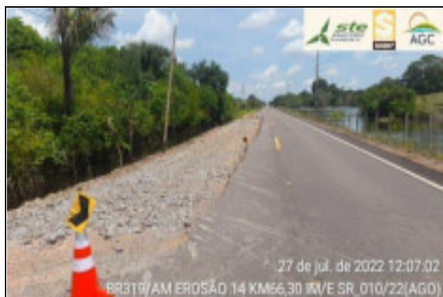
BR-319/AM EROSÃO LE KM: 66,300 ESTACA: 2.665
