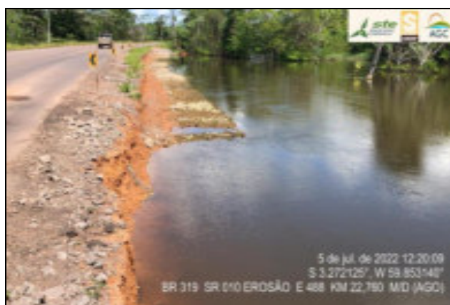
5 de jul. de 2022 12:20:09 S 3.272125°, W 59.853148° BR 319 SR 010 EROSÃO E 488 KM 22,760 MID (AGO) BR-319/AM EROSÃO LD KM: 22,700 ESTACA: 485
