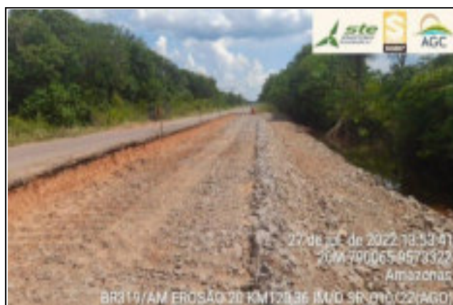
BR-319/AM EROSÃO LD KM: 120,360 ESTACA: 5.368
