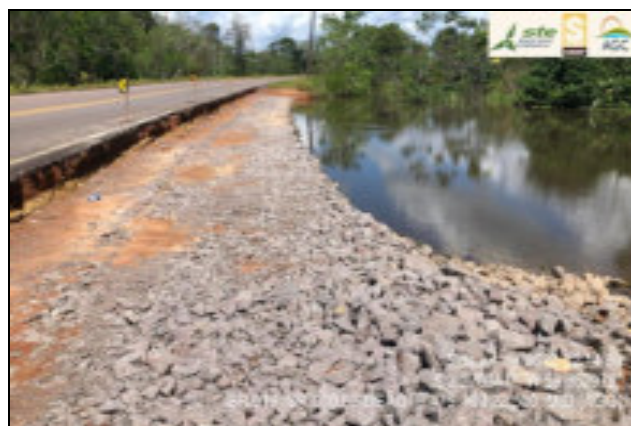
BR-319/AM EROSÃO LD KM: 22,500 ESTACA: 475
