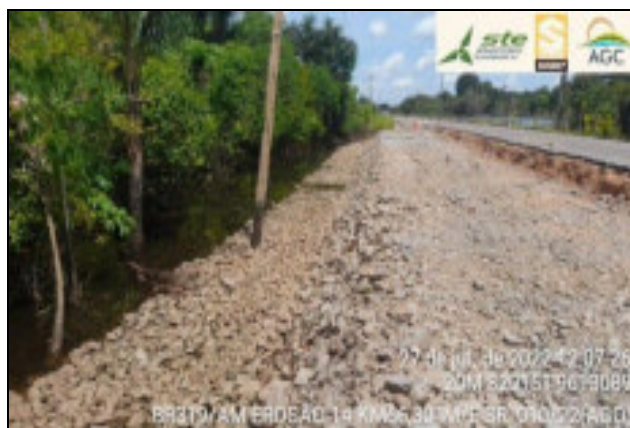
BR-319/AM EROSÃO LE KM: 66,300 ESTACA: 2.665
