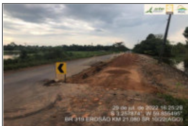
29 de jul. de 2022 16:25:28 S 3.257874°, W 59.856495° BR 319 EROÇÃO KM 21,080 SR 10222(AGO)
