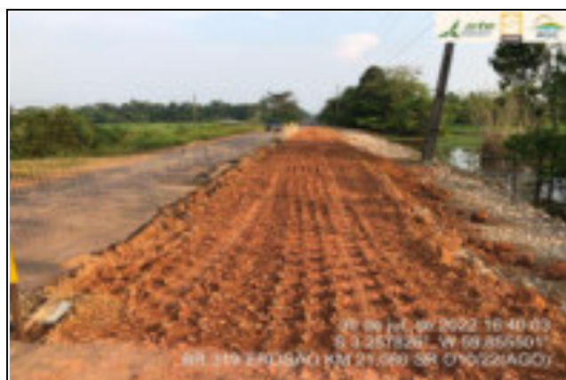
29 de jul. de 2022 16:40:03 S 3.257826°, W 59.856501° BR 319 EROÇÃO KM 21,080 SR 07022(AGO)
