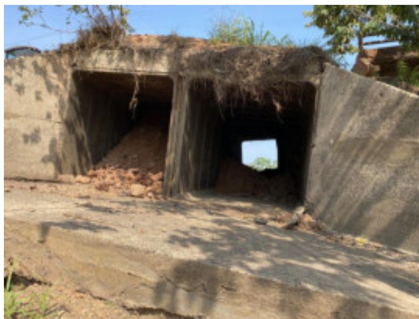
FOTO 7: BDCC JUSANTE COM SITUAÇÃO CRÍTICA DO LADO ESQUERDO E DIREITO.
