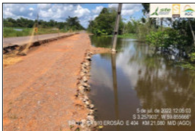
5 de jul. de 2022 12:05:03 S 3.257903°, W 59.855868° BR 319 SR 010 EROÇÃO E 404 - KM 21,080 MID (AGO)
