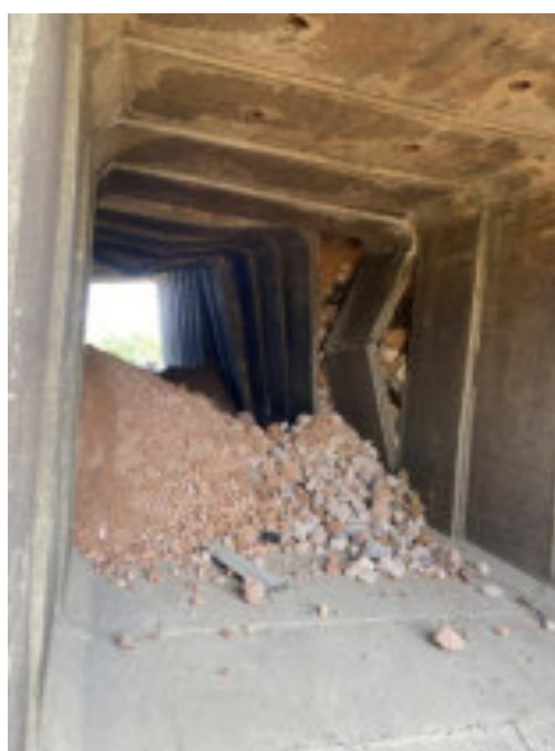
FOTO 8: SITUAÇÃO CRÍTICA DAS ADUELAS DENTRO DO BDCC.
