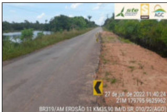
BR-319/AM EROSÃO LD KM: 35,900 ESTACA: 1.145
