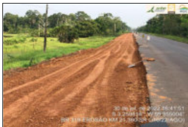
BR-319/AM EROSÃO LE KM: 21,380 ESTACA: 419
