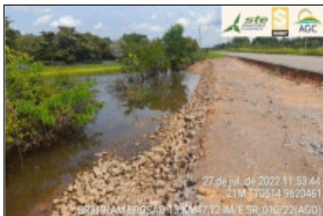
BR-319/AM EROSÃO LE KM: 47,120 ESTACA: 1.705
