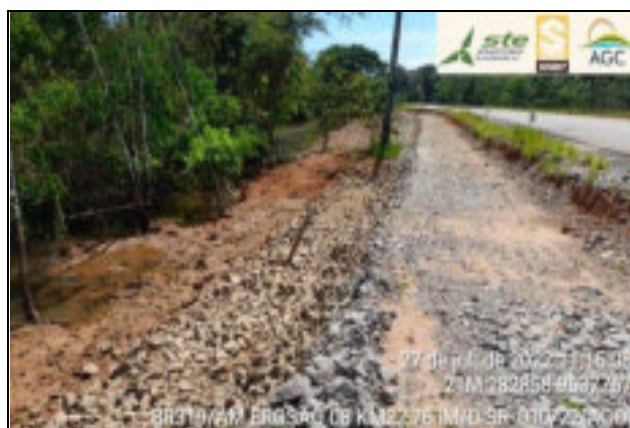
27 de jul. de 2022 11:15:38 21M282858 4637707 BR 319/AM EROSÃO DA KM 22,76 MID SR 010/22(AGO) BR-319/AM EROSÃO LD KM: 22,700 ESTACA: 485
