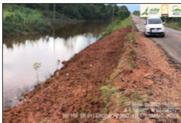
BR-319/AM EROSÃO LD KM: 175,640 ESTACA: 8.132
