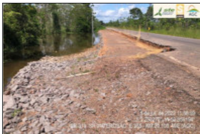
BR-319/AM EROSÃO LE KM: 20,100 ESTACA: 355
