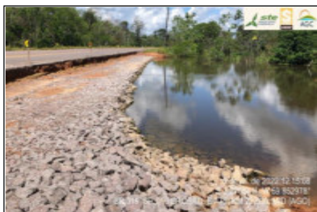
BR-319/AM EROSÃO LD KM: 22,500 ESTACA: 475
