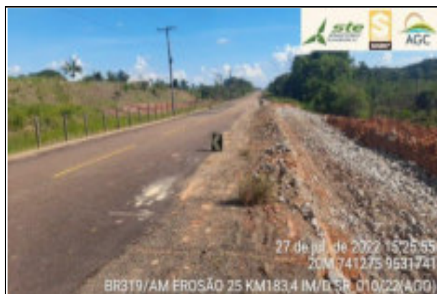
BR-319/AM EROSÃO LD KM: 183,40 ESTACA: 8.519
