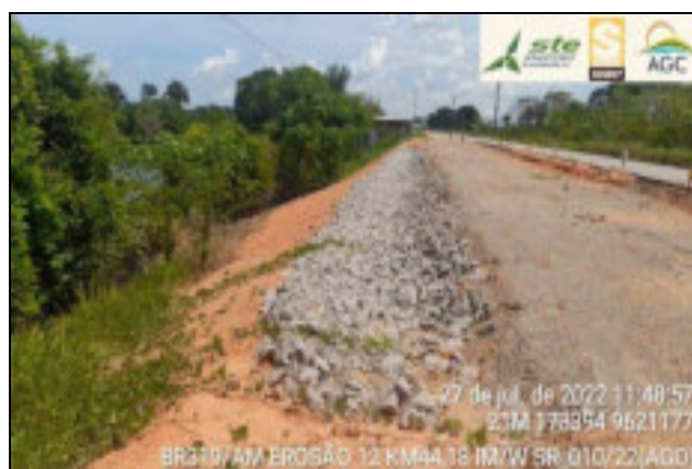
BR-319/AM EROSÃO LE KM: 44,180 ESTACA: 1.559
