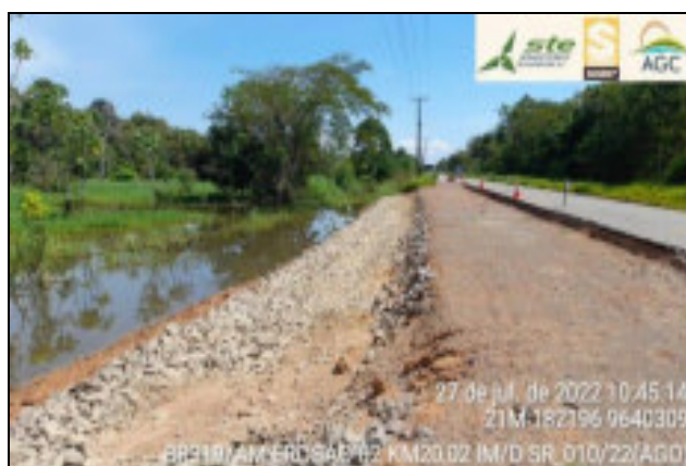
BR-319/AM EROSÃO LD KM: 20,020 ESTACA: 350
