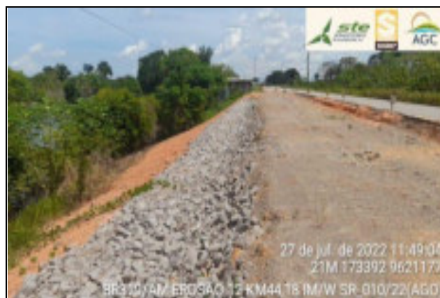
BR-319/AM EROSÃO LE KM: 44,180 ESTACA: 1.559
